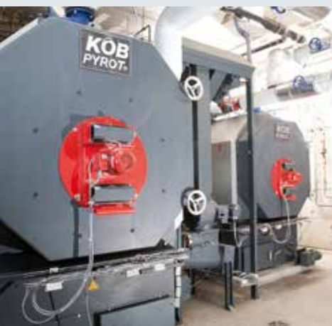
Holzpelletdoppelkesselanlage mit 540 kW und 400 kW Leistung
